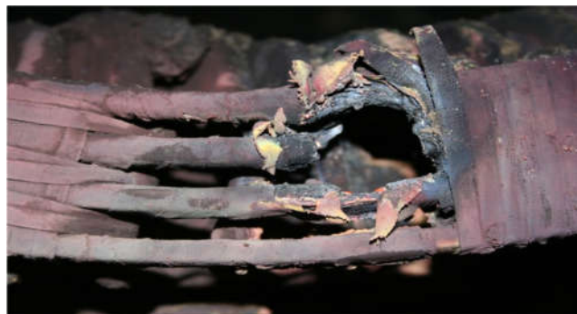
Рис. 3 - Повреждение обмоток статора ТЭД Fig. 3 - Damage to the stator windings ETM
