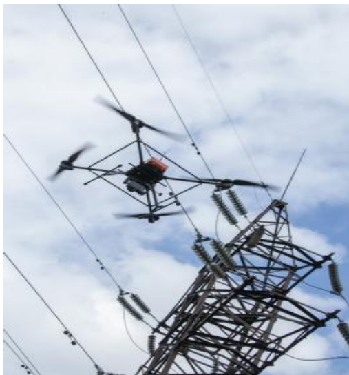
Рисунок 3 – Выявление дефектов с помощью квадрокоптера
